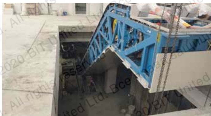
Монтаж несущей рамы поэтажного эскалатора к железобетонным плитам перекрытия торгового центра (ТЦ «Галерея», г. Краснодар, 2011 г.)
