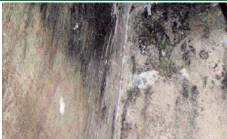
Повреждения от протечек воды
