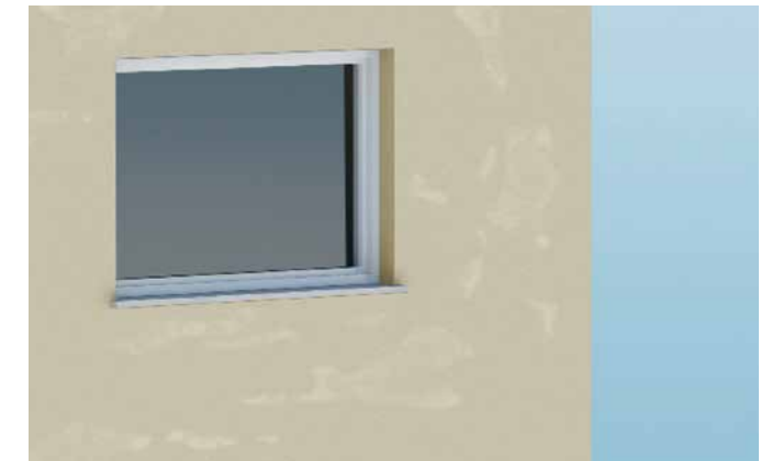
Рис. 53 Колерованная штукатурка с выцветами
